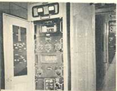
Una delle cabine dell'emettitore AME da 5 KW.
